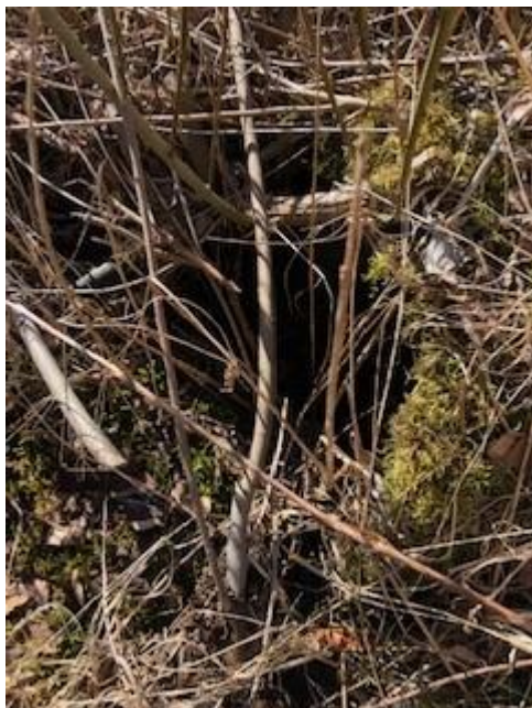
Trumma 74 uppströms, väldigt dold
