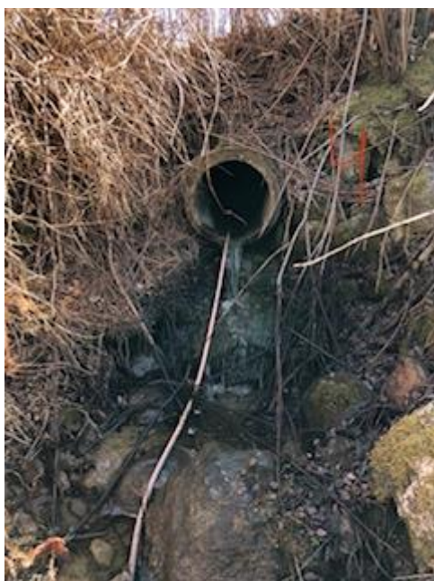
Trumma 77 nedströms (bild uppströms saknas).
