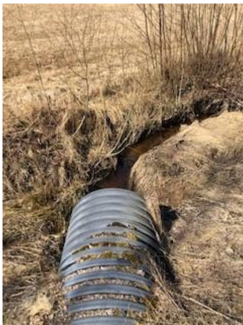
Trumma 28 uppströms ovanifrån.
