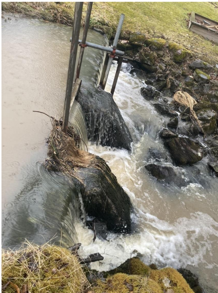
Bild 11: Hinder nedströms vägtrumma nr 47.
