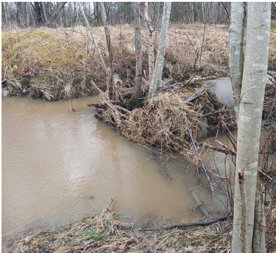
Bild 7: Vägtrumma nr 48. Mynning uppströms som täckts för av bävrar.
